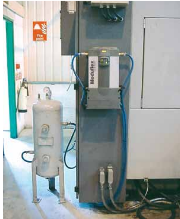
Un mini-sécheur d'air installé pour approvisionner des machines-outils numériques en air de commande.
